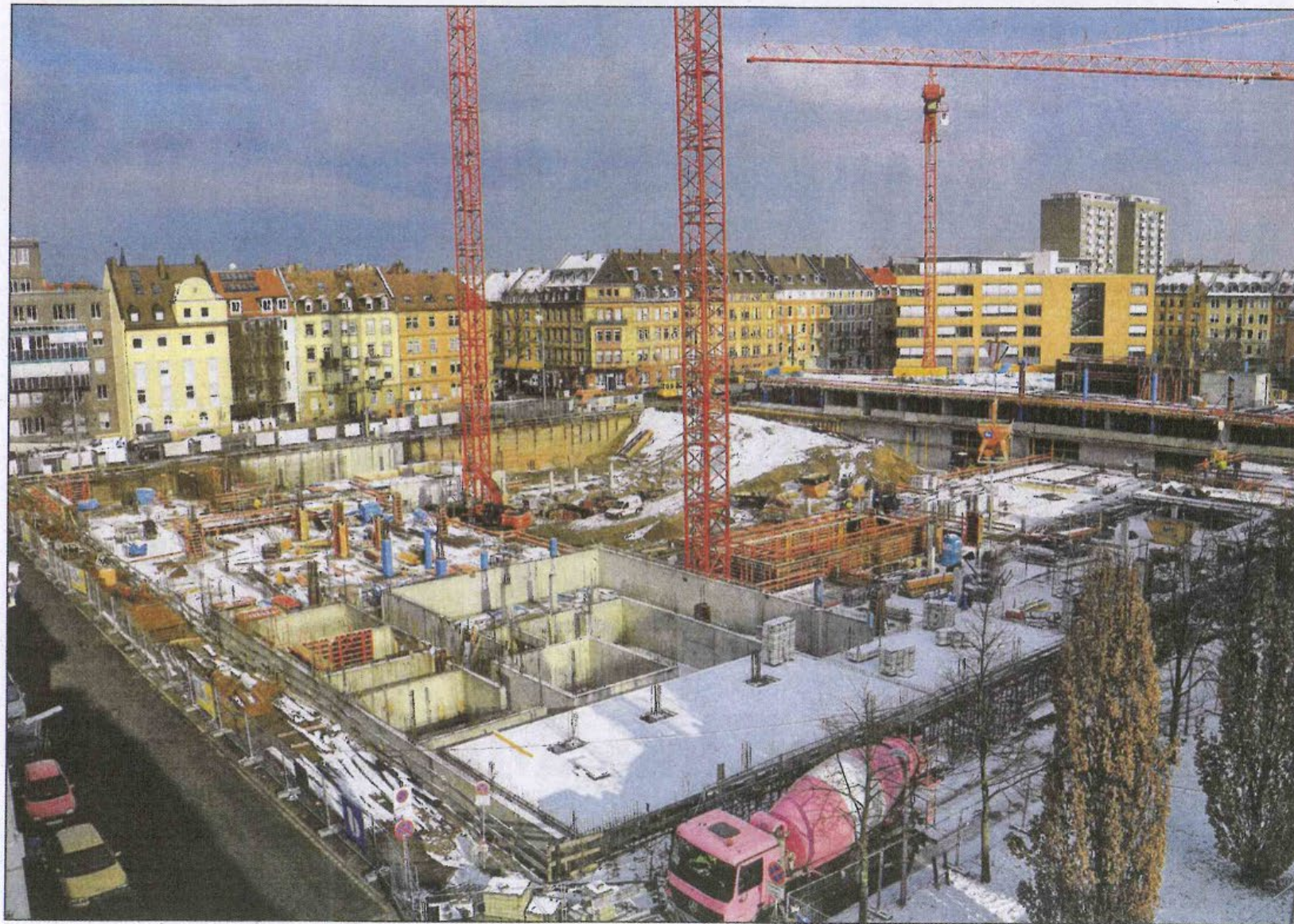
BETONARBEITEN IM SCHNEE: Auf der Großbaustelle an der Gartenstraße (hinten) wächst das Garten Carré – ein architektonische Ausrufezeichen der Urbanität aus fünf Baukörpern mit Büros, Praxen und Wohnungen in der Südweststadt. Foto: joo
